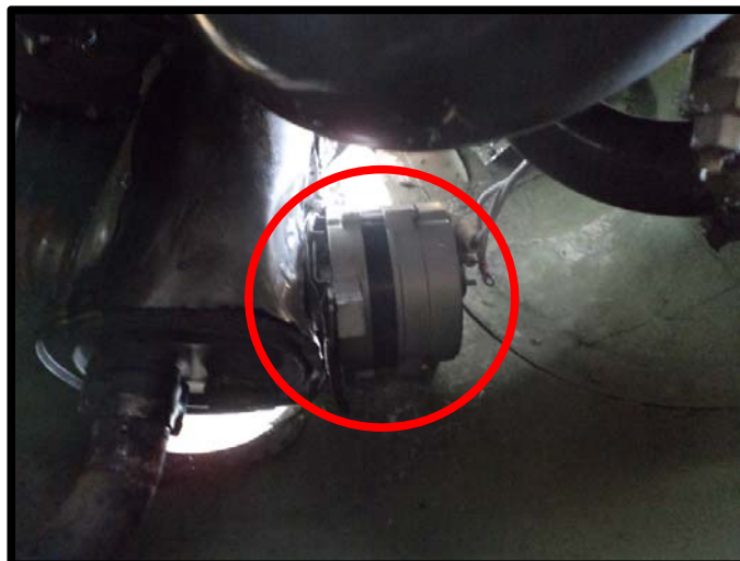
Fotografía No. 10 Vista del alternador de corriente, caído por la vibración.
